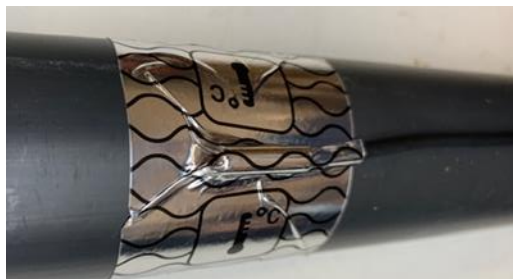
Fig 4 – Installation de la sonde de température
